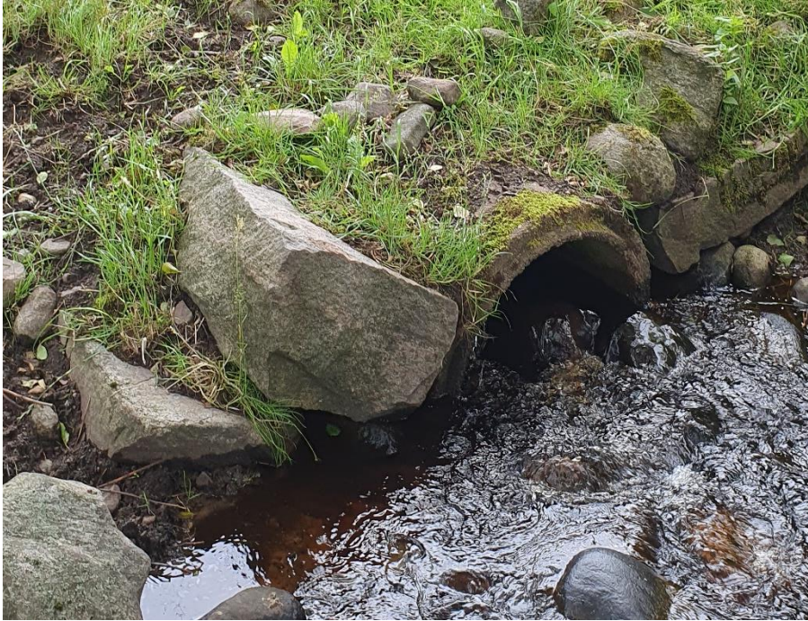
Figur 29. vandringshinder 6 i den västra fåran, en 25 meter lång kulvert.
