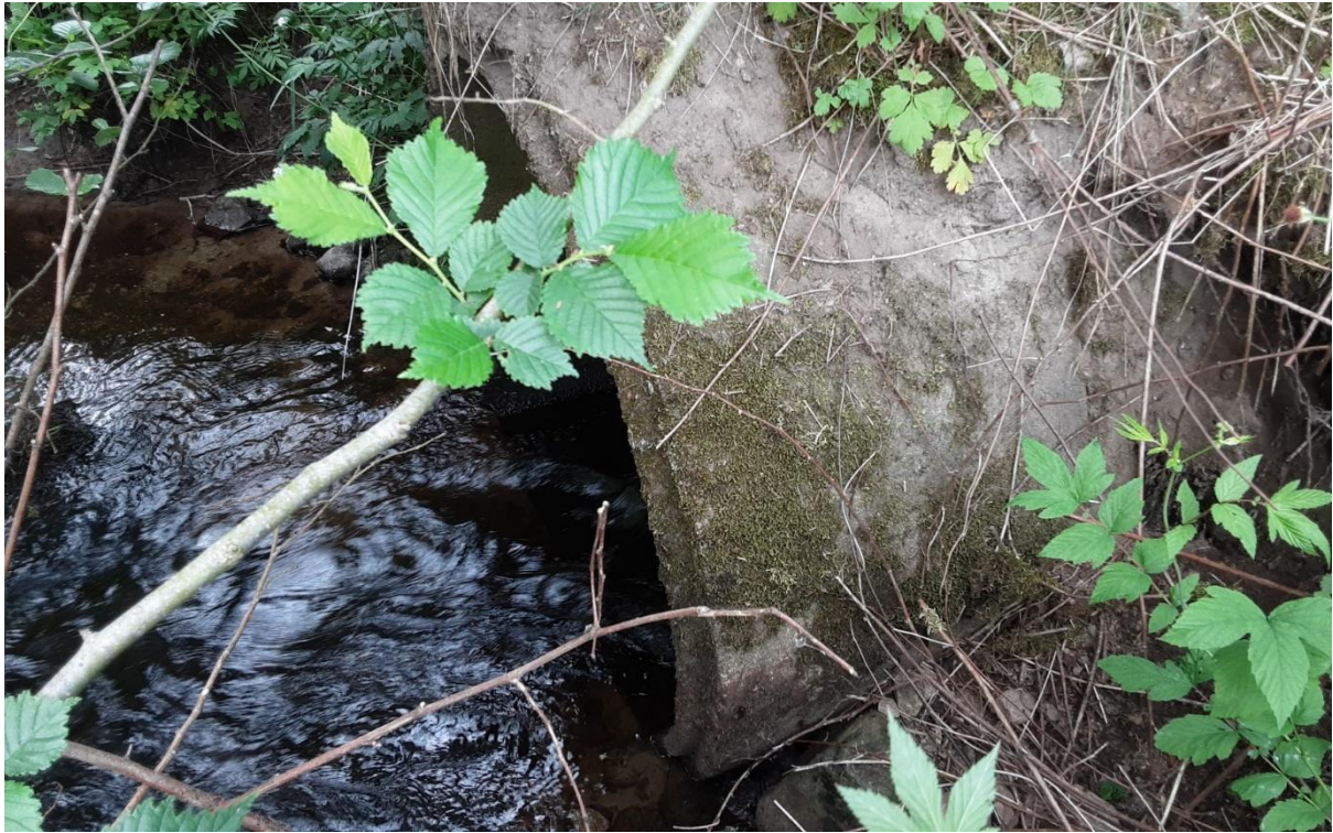
Figur 24. Vägtrumma i västra grenen, vandringshinder 1.
