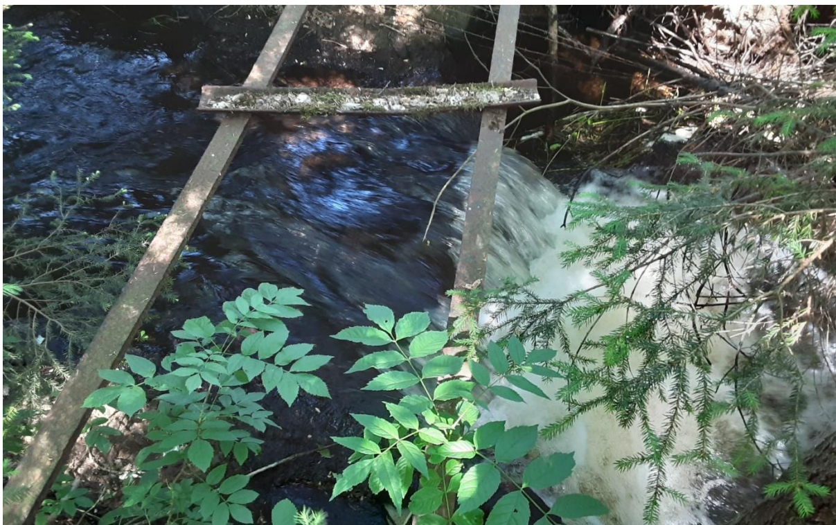
Figur 26. Betongklack i västra grenen som är partiellt vandringshinder för öring.
