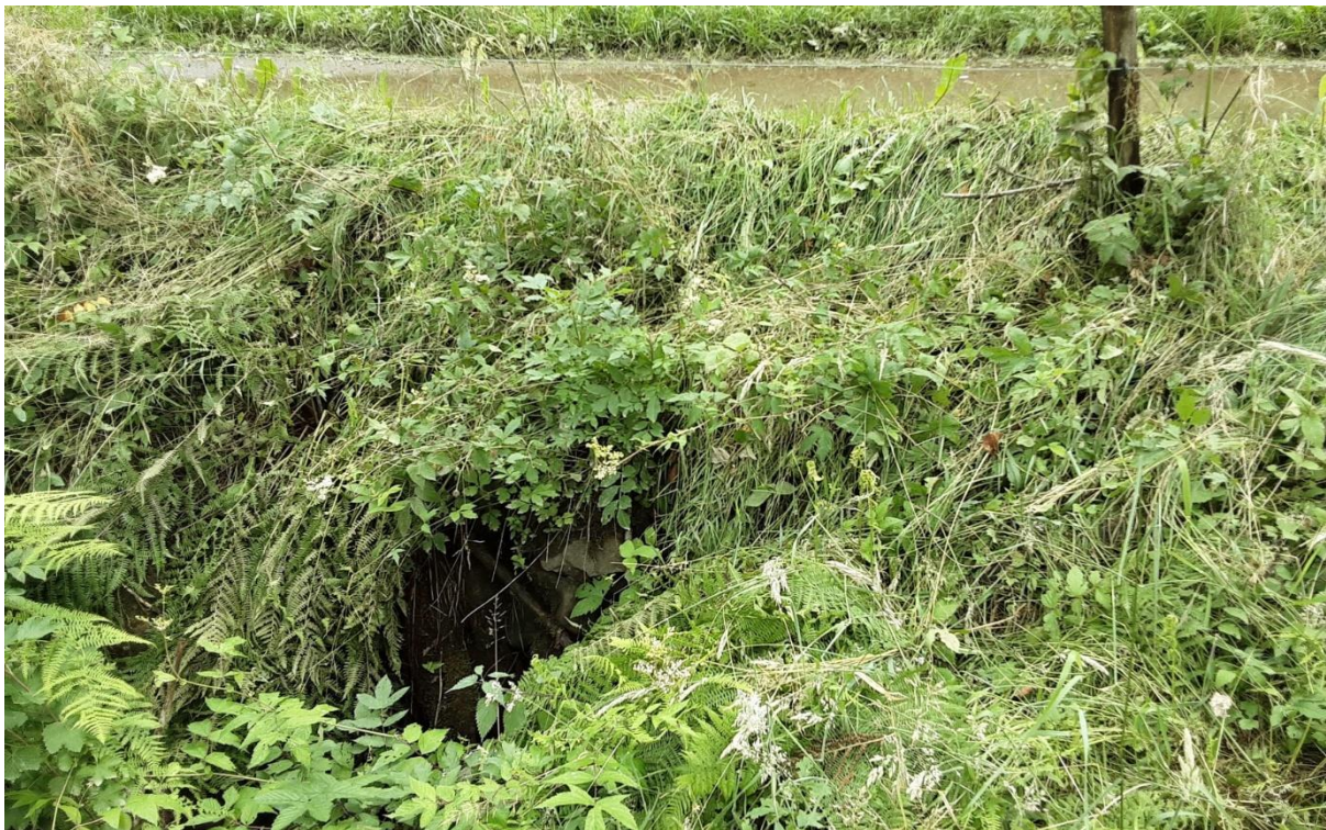
Figur 31. Sista hindret i västra grenen, en vägtrumma.
