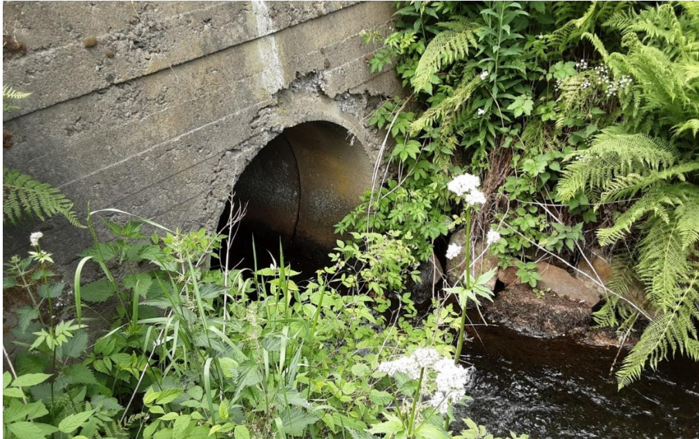
Figur 27. Dålig vägtrumma, vandringshinder 4 i västra grenen.
