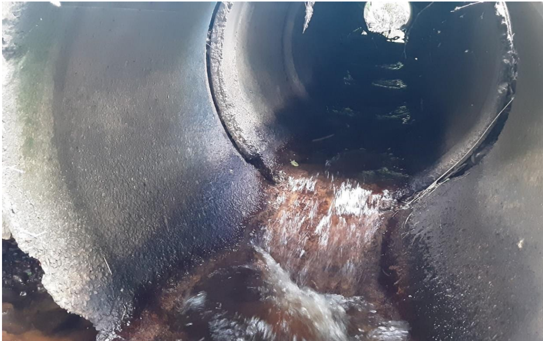
Figur 22. Dålig vägtrumma, vandringshinder 7.
