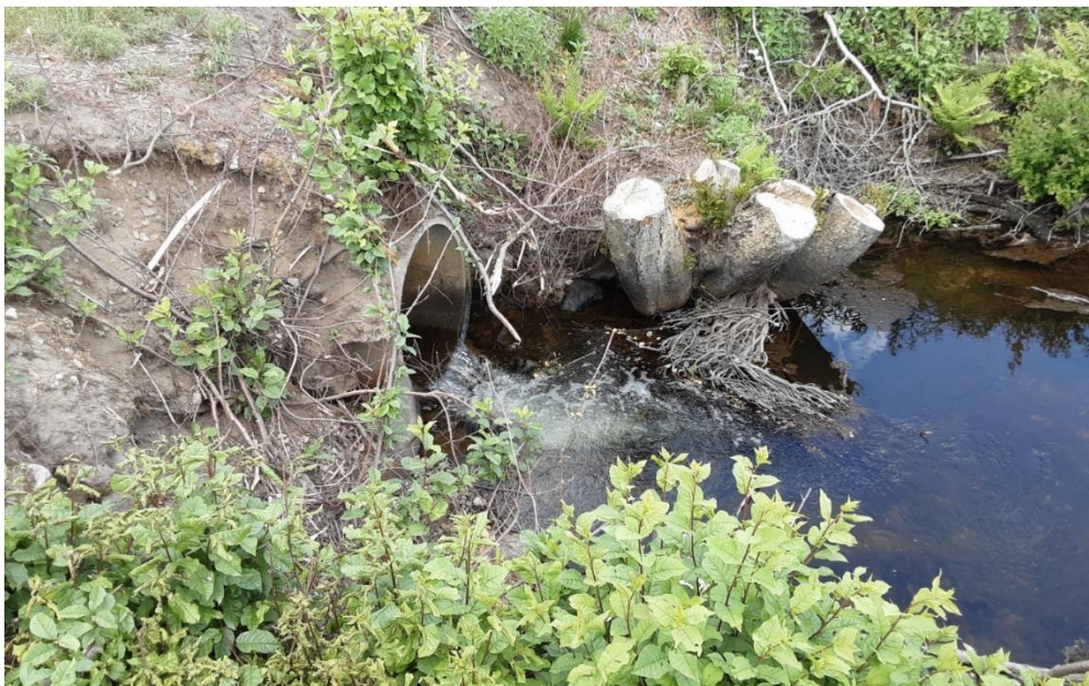
Figur 28. Dåligt lagd vägtrumma i västra grenen, vandringshinder 5.
