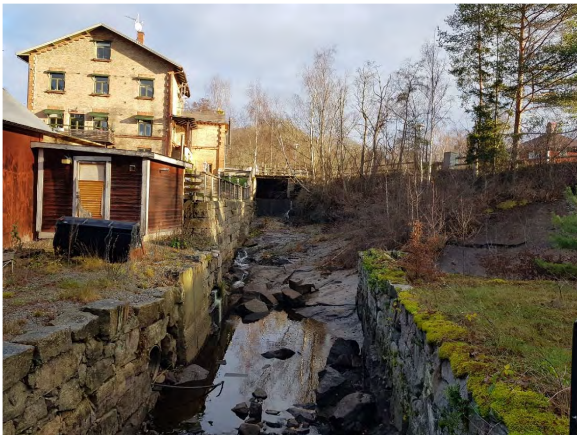
Figur 36. Den nedre delen av spillfåran vid Granefors bruk (övre) i Mieån. Här bör man höja vattennivån upp mot dammen. I den övre delen bör man gjuta en kortare slitsränna för att kunna ansluta fiskväg och damm.
