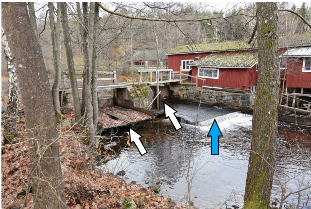
Figur 54. Jeppshoka såg i Mieån fotad från sydväst. Vita pilar: luckor, blå pil: betong. Foto: Jonathan Bark
