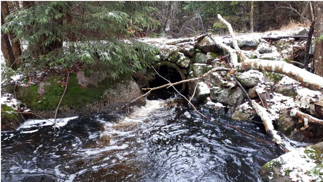
Figur 100. Vägtrumma på sträcka 11 i Påkamålabäcken. Foto: Jonathan Bark
